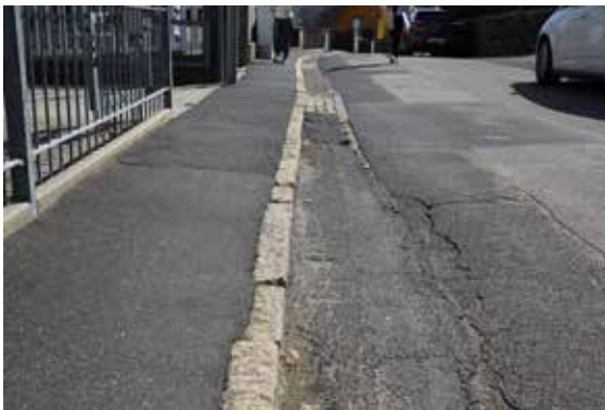
Abbildung 32: Beispiel für Straßenschäden
