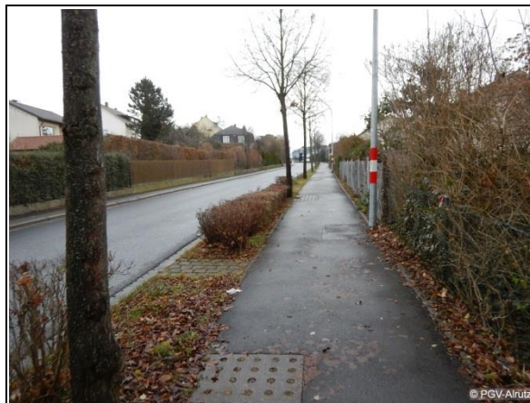
Krumbacher Straße Radverkehrsanlage in unzureichender Breite
